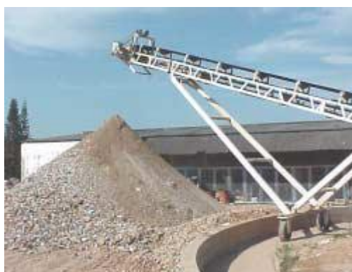
Figura 18: Equipamento da usina: correia transportadora e disposição da bica corrida.
